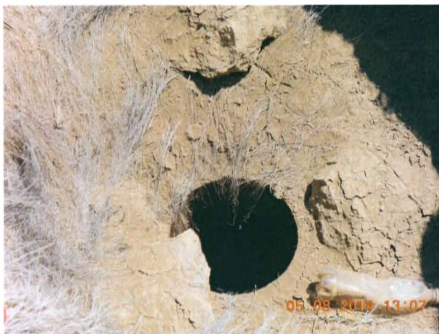
Fotografía N° 3. Se observa casing de 10 plg de diámetro abierto y expuesto al ambiente sin accesorios que aseguren su hermetismo.
