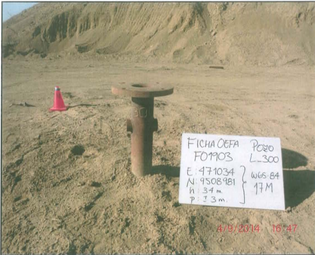
Fotografía N° 1. Cabezal del pozo que emerge 0,6 m desde el nivel de suelo y que está compuesto por brida unida al casing.
