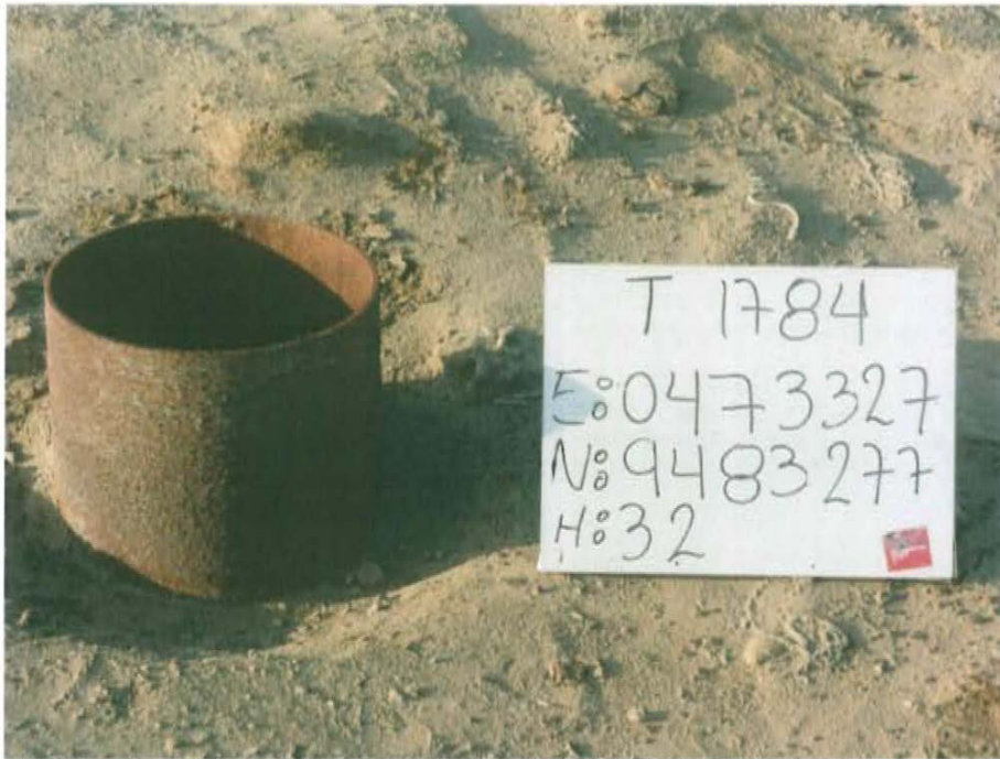
Fotografía N° 1. Vista de la ubicación del pozo donde se observa el casing sin brida ni válvulas en estado de corrosión y abierto al ambiente.
