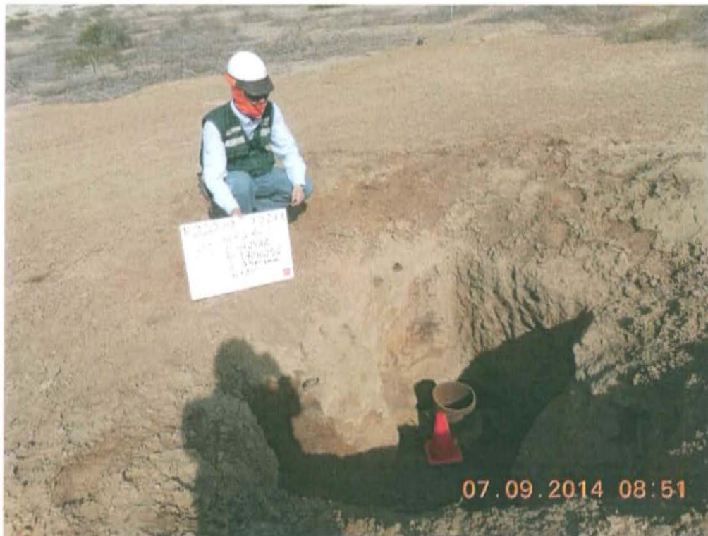
Fotografía N° 1. Identificación del pozo inactivo con código PERUPETRO T2273. Presenta casing con brida sin cabezal o válvulas que aseguren su hermetismo.
