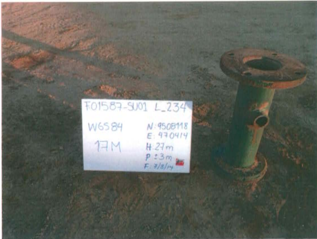
Fotografía N° 1. Pozo inactivo sin cabezal y con brida de 15 pulgadas de diámetro y expuesto al ambiente.
