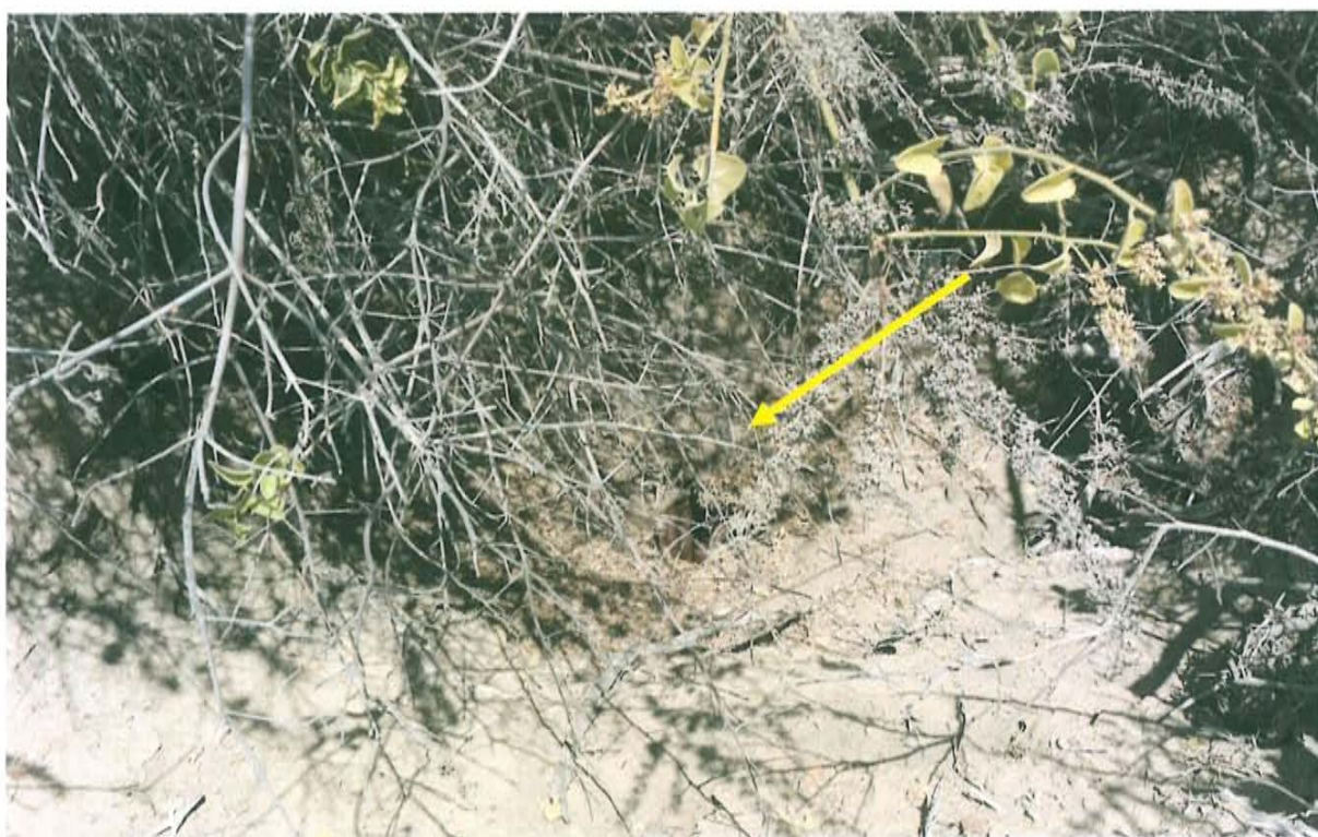
Fotografía N° 2. Detalle del Pozo T394, en el que se visualiza el casing corroído cortado a nivel de la superficie del suelo.
