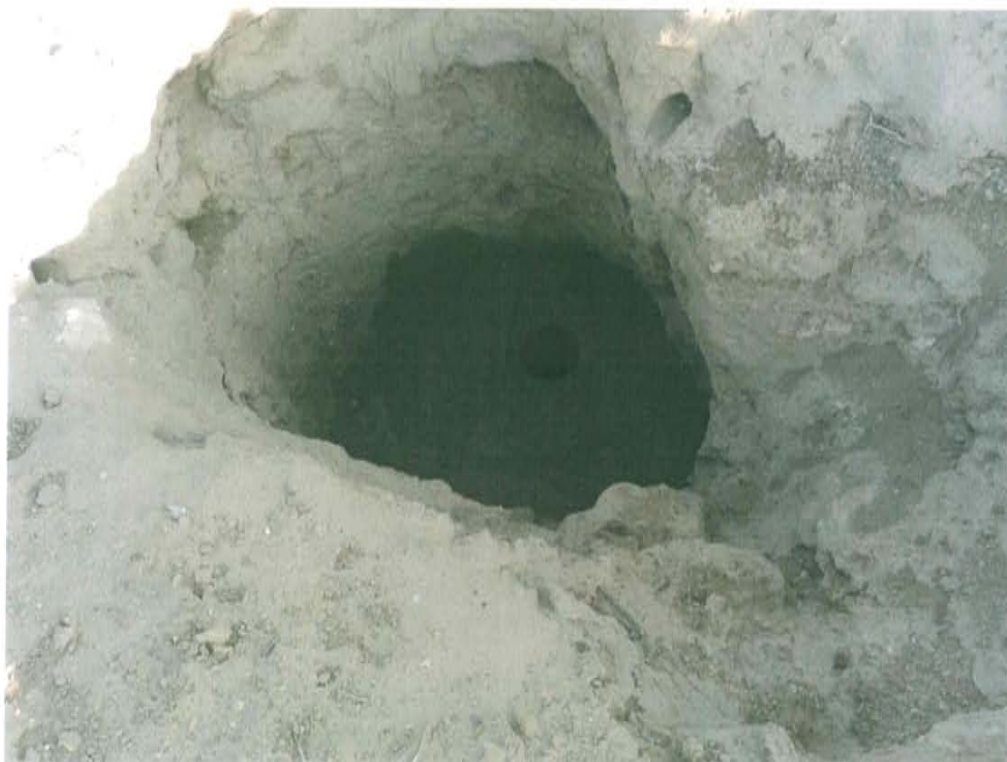
Fotografía N° 2. Vista del interior del hoyo donde se encuentra el Pozo T2935, se observa casing cortado y corroído a nivel del fondo del hoyo.
