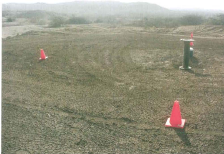
Fotografía N° 2. El pozo carece de válvulas que garanticen un cierre hermético.
