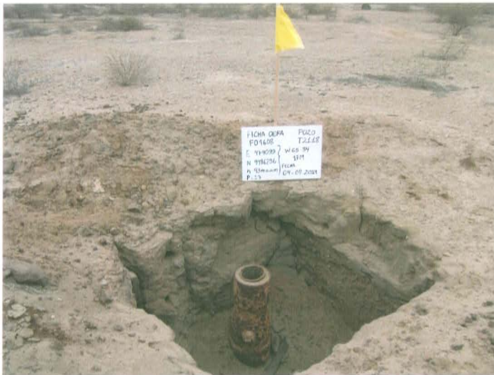
Fotografía N° 1. Se observa doble casing 7 y 10 pulgadas, sin cabezal ni válvulas que aseguren su hermetismo del Pozo T2118.
