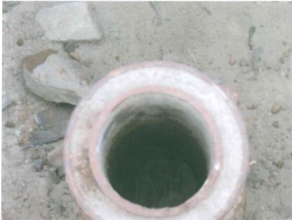
Fotografía N° 3. Se observa doble casing los cuales se encuentran cementados en la sección anular y lleno de arena al interior del casing de producción lo cual no garantiza su hermetismo.
