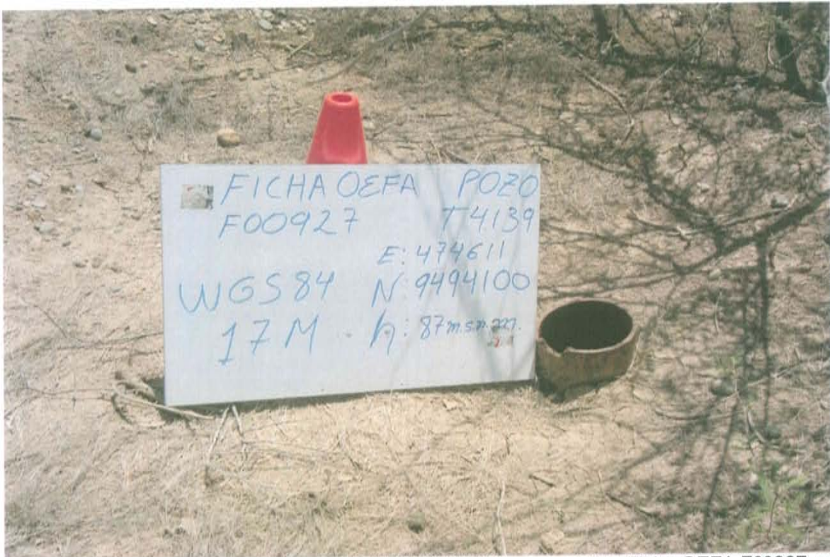
Fotografía N° 01.- Pozo con código PERUPETRO T4139 y con código Ficha OEFA F00927, se observa el casing del pozo sin cabezal o alguna válvula, por lo que se encontraría expuesto al ambiente.
