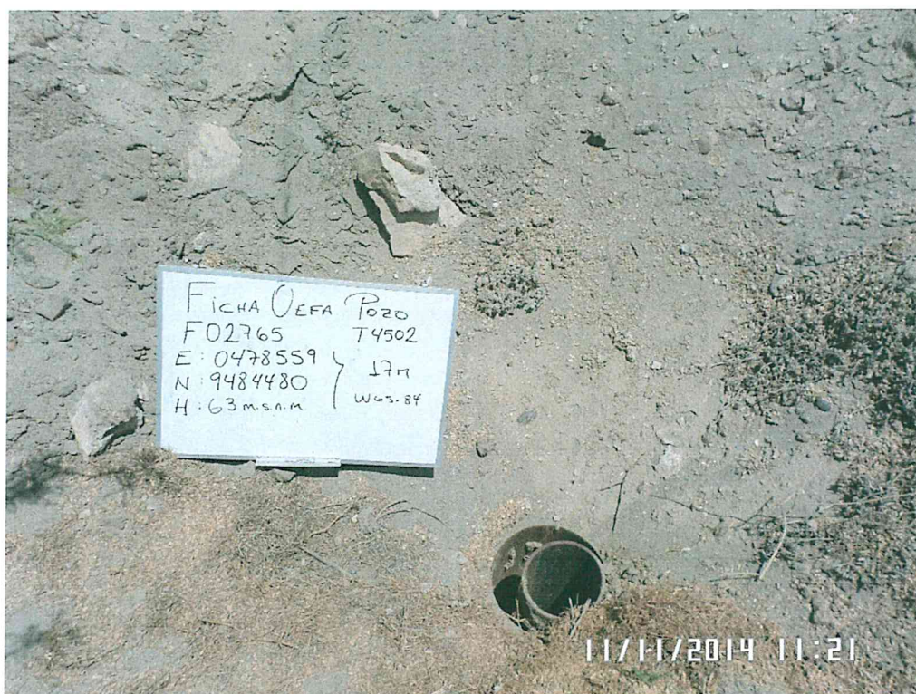
Fotografía N° 1. Vista pozo del T4502, se observa el casing a nivel del suelo y abierto al ambiente.
