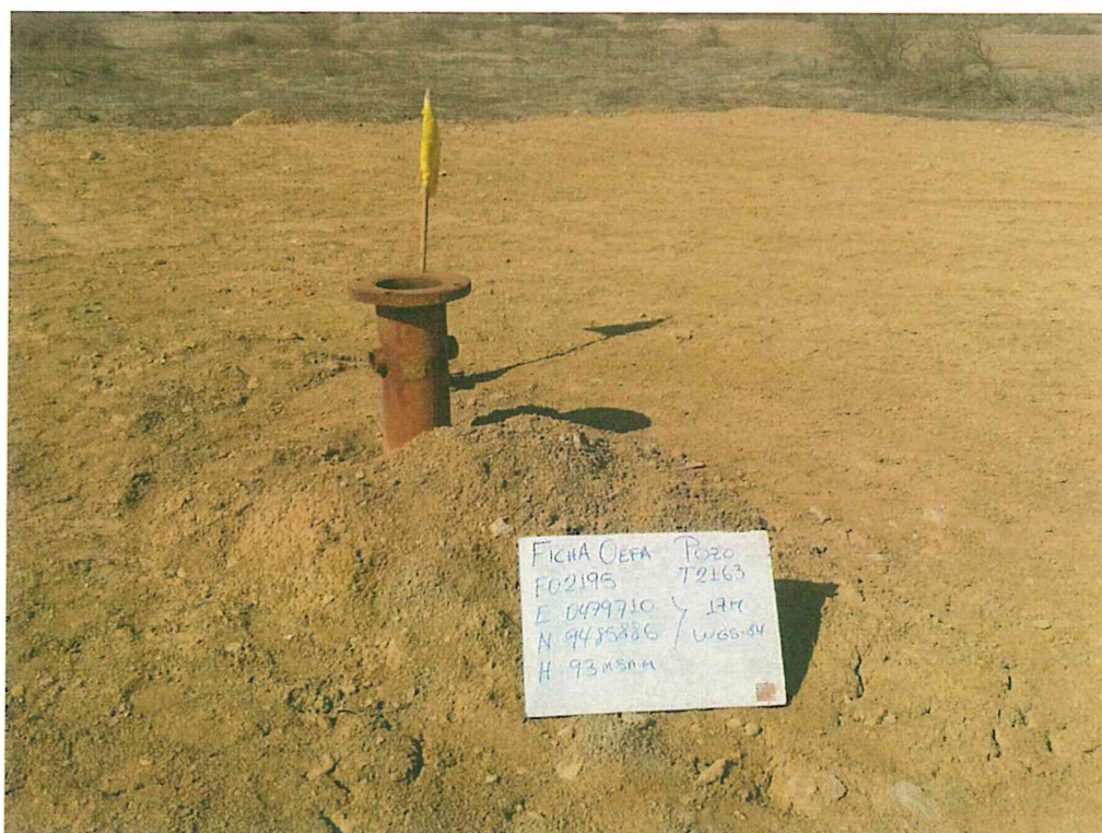
Fotografía N° 1. Vista del pozo T2163, se observa el casing corroído y abierto al ambiente.
