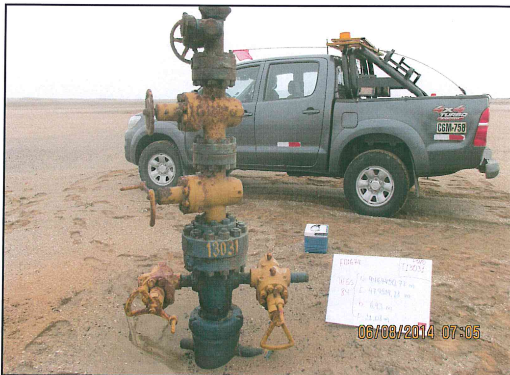
Fotografía N° 1. Cabezal de pozo compuesto por arreglo de tuberías, bridas y válvulas que emerge a una altura de 1,5 m desde la superficie del suelo.
