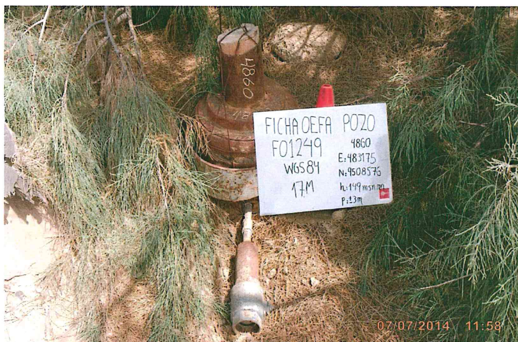
Fotografía N° 1. Vista del pozo petrolero inactivo, se observó casing corroído.
