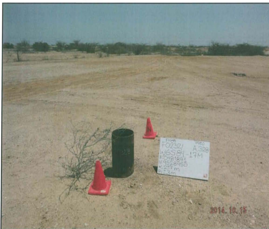
Fotografía N° 1. Pozo A_328 con casing corroído de 8 plg que emerge a una altura de 0,5 m desde la superficie del suelo.
