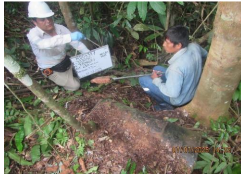
Vista panorámica de cilindro metálico vacío, semienterrado y en proceso de oxidación y corrosión en el hincado 5, ubicado en la referencia R004317.
