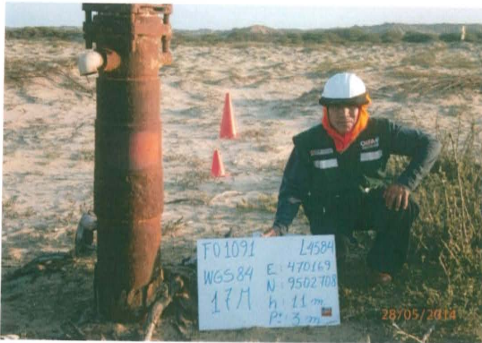
Fotografía N° 1. Vista de ubicación del pozo donde se observa el pozo con el casing y brida en estado de deterioro y abierto.
