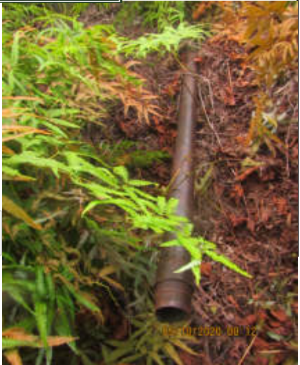
Tubería de descarga del tanque sumidero, sobre la pendiente muy empinada de 50 a 75%.
