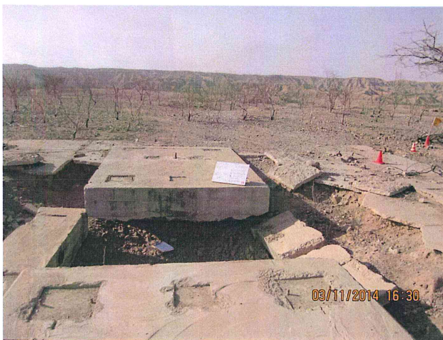
Fotografía N° 3. Se puede apreciar las plataformas fraccionadas de concreto instalaciones mal abandonadas.
