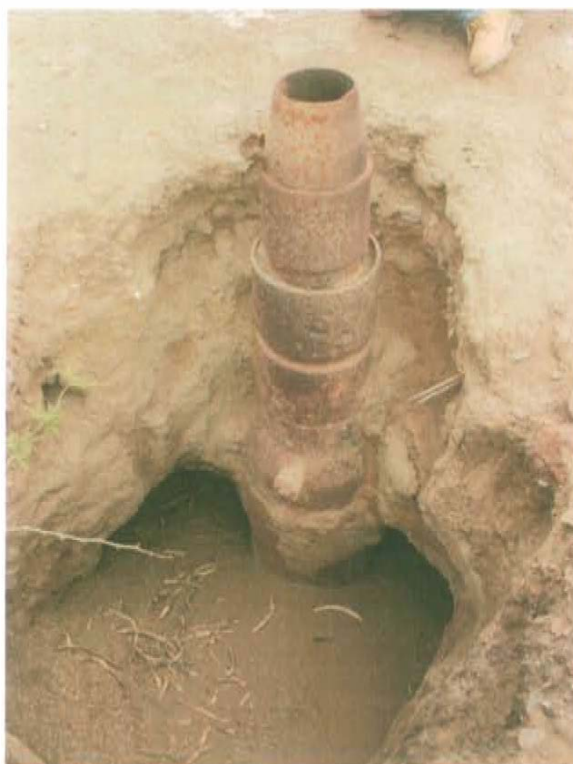
Fotografía N° 1. El pozo presenta doble casing cementado, corroído, abierto con una reducción del casing de producción de 6,5 pulgadas de diámetro
