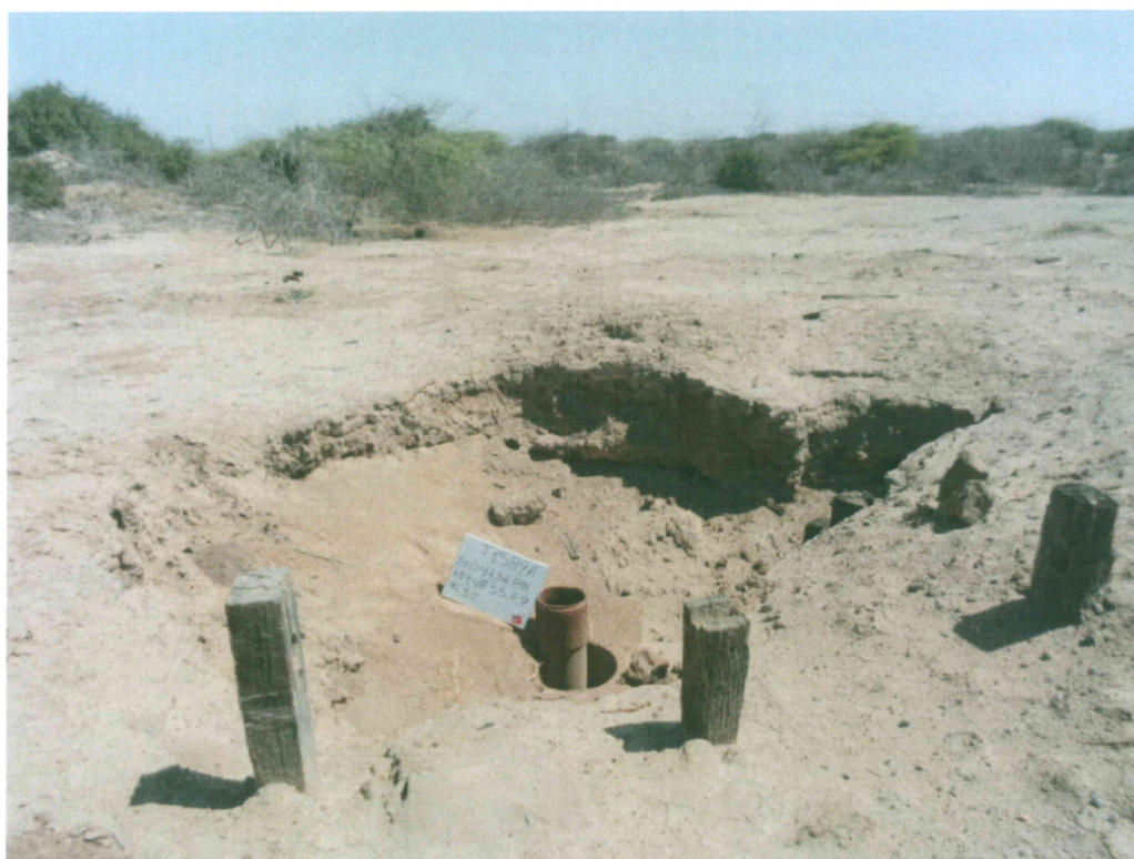
Fotografía N° 2. Vista del pozo, sin cabezal el casing y tubo expuesto dentro de hoyo el cual abarca un área de 16,73 m 2 .
