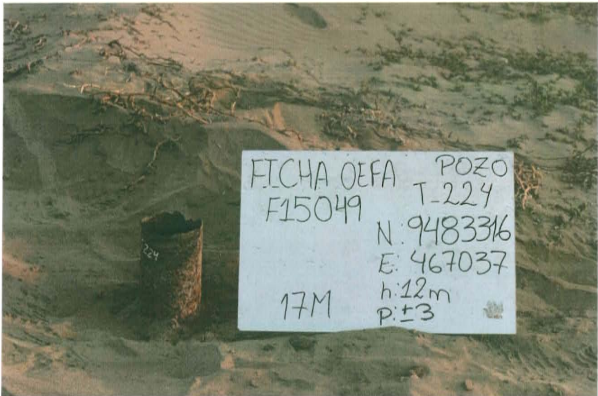
Fotografía N° 2. Se observa Pozo que presenta casing corroído, sin elemento de cierre en superficie (válvulas, llaves entre otros) que garanticen un cierre hermético del pozo.
