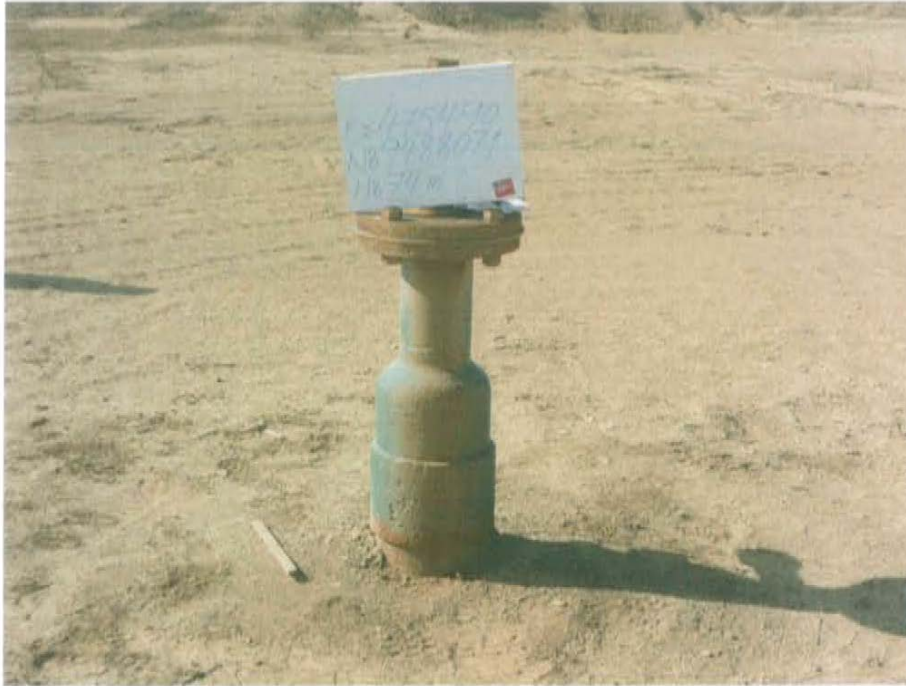
Fotografía N° 1. Pozo mal abandonado con código PERUPETRO T2296, posee cabezal con brida y válvula. No se evidencia afloramiento superficial de fluidos ni suelo impregnado con hidrocarburo.
