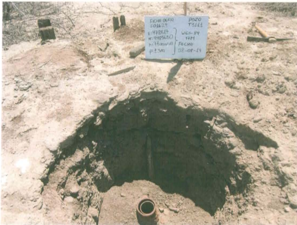
Fotografía N° 1. Pozo inactivo con código PERUPETRO T3111. Se observa casing con brida sin cabezal.
