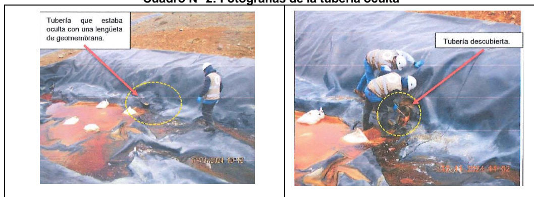
Cuadro N° 2: Fotografías de la tubería oculta
