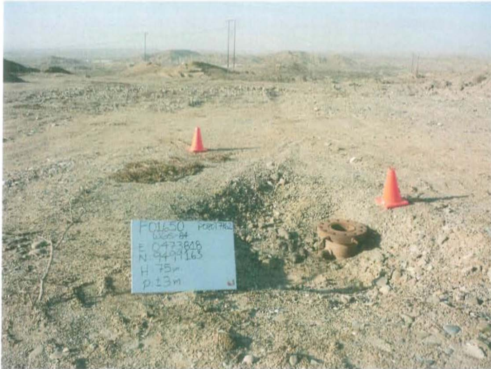
Fotografía N° 1. Pozo inactivo de la ficha F01650 que muestra casing de superficie a 0,3 m sobre el nivel del suelo, corroído y sin cantina.
