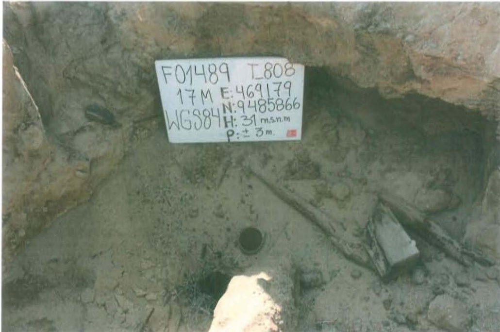
Fotografía N° 1. Pozo T_808, presenta casing de aproximadamente 4½ pulgadas de diámetro, cortado y corroldo.
