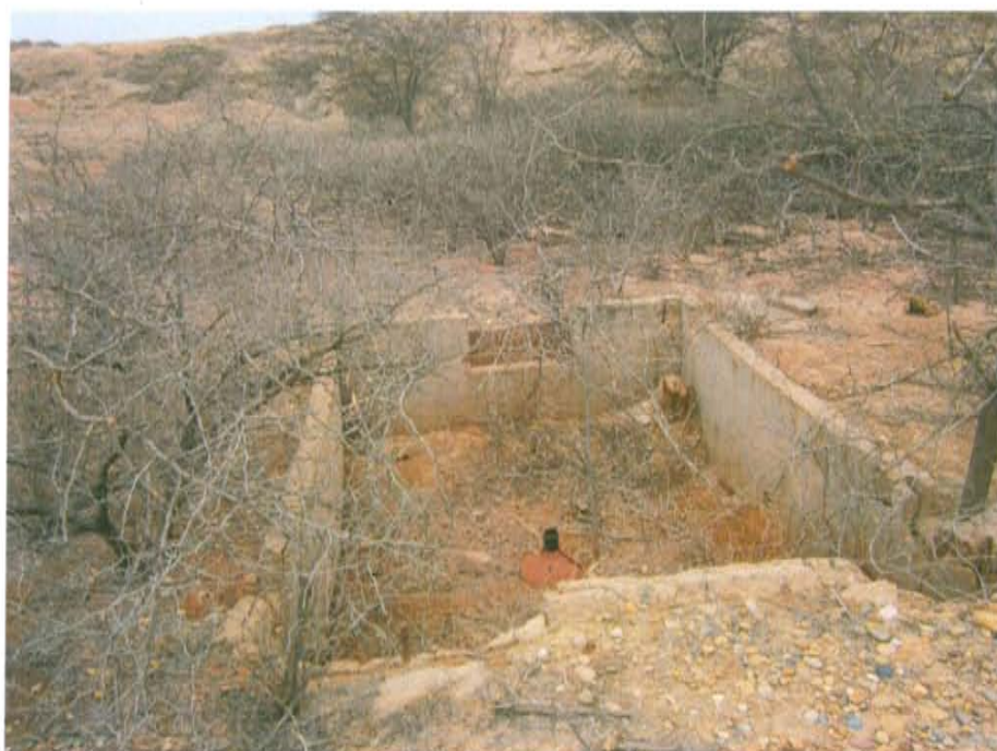
Fotografía N° 2. Se observa la estructura del pozo expuesto al ambiente en estado de corrosión, abierto sin elemento que garanticen un cierre hermético del pozo.
