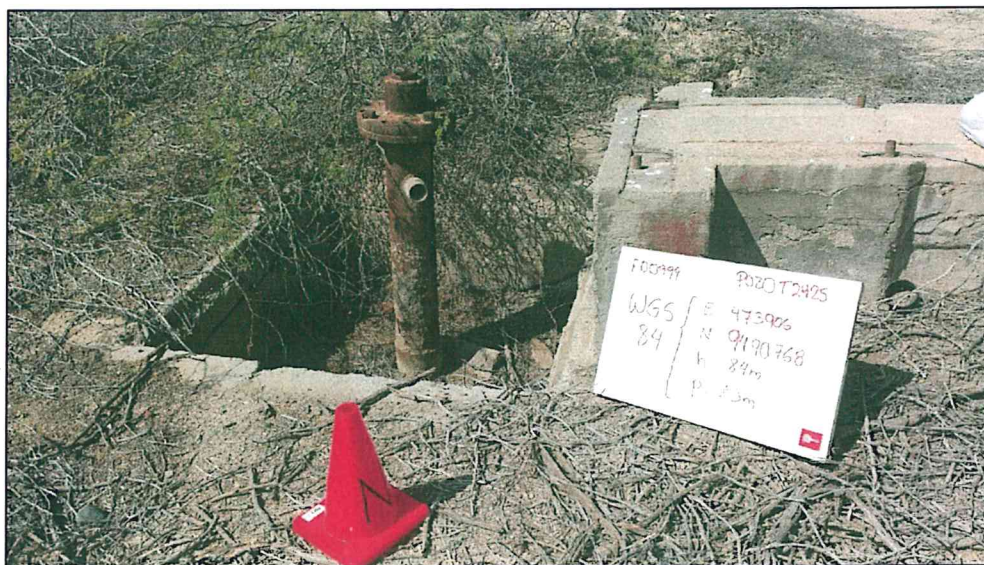
Fotografía N° 1. Vista del Pozo T2425, casing con brida y sin válvula que asegure su hermetismo.
