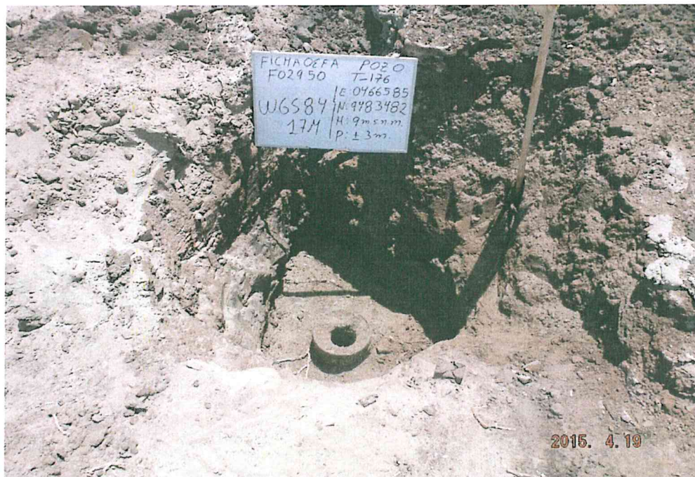
Fotografía N° 2. Pozo T_176, luego de haber realizado una excavación de 1,4 m de profundidad se encontró el casing sin cabezal ni válvulas que aseguren su hermetismo.
