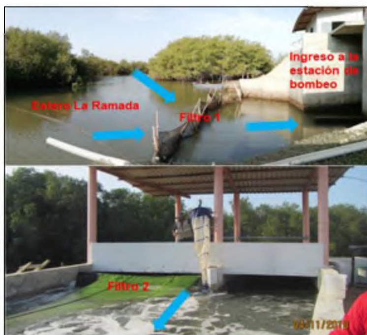
Figura 7.4. Sistema de captación de agua: filtro 1 (estero La Ramada), estación de bombeo (arriba) y filtro 2 (abajo)
