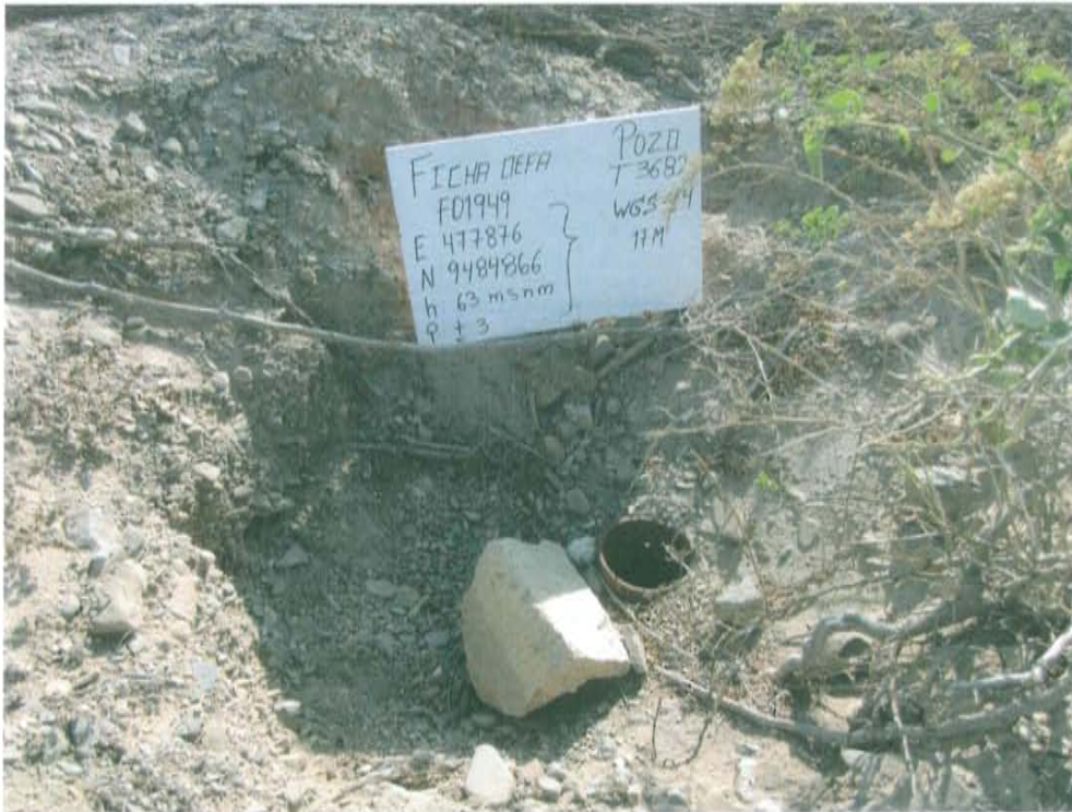
Fotografía N° 1. Se observa el Pozo T3682 el cual presenta casing cortado al ras del suelo abierto y expuesto al ambiente.
