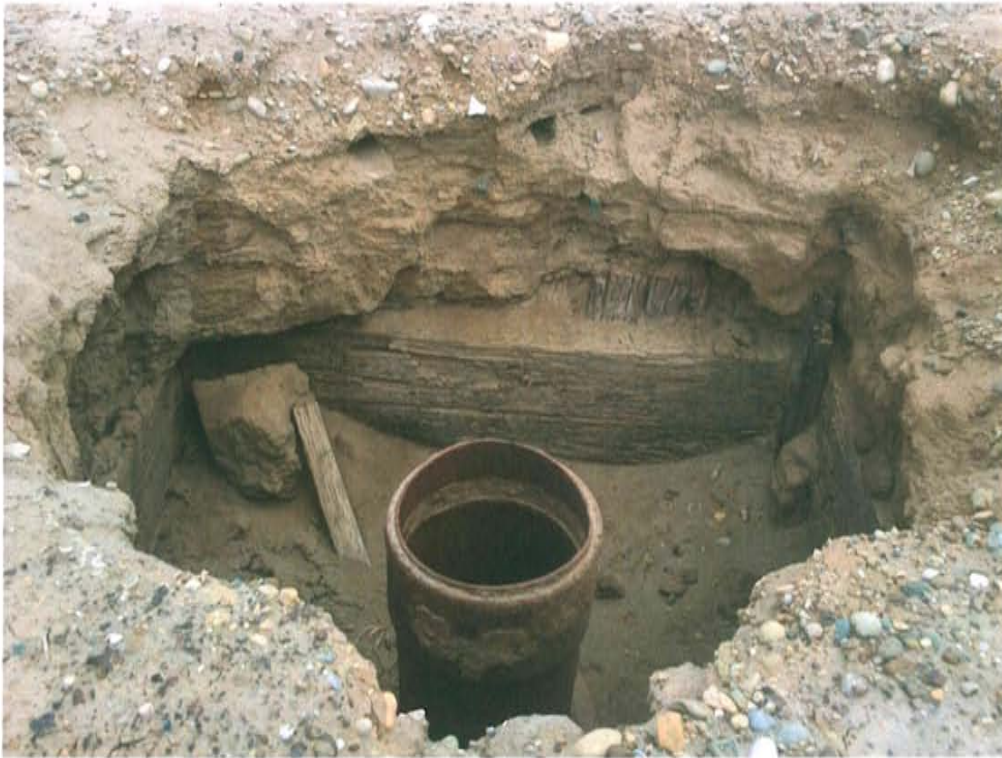
Fotografía N° 1. Pozo con código PETRUPETRO T1792 inactivo mal abandonado, dentro de una cantina destruida se encuentra el casing cuyo cabezal ha sido cortado.
