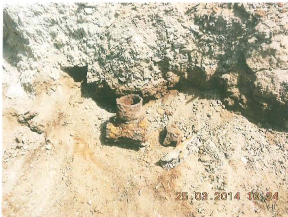
Fotografía N° 2. Vista de accesorio de tubería corroido ubicado a 9 m al noroeste de la posible ubicación del pozo T_831 y suelo con presencia de hidrocarburos.
