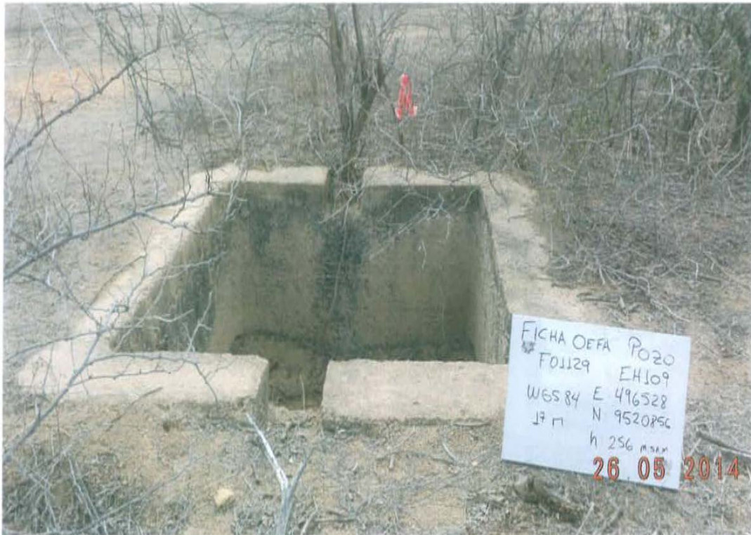
Fotografía N° 1. Identificación del pozo inactivo con código PERUPETRO EH109. Presenta casing expuesto en el interior de una cantina de concreto armado.
