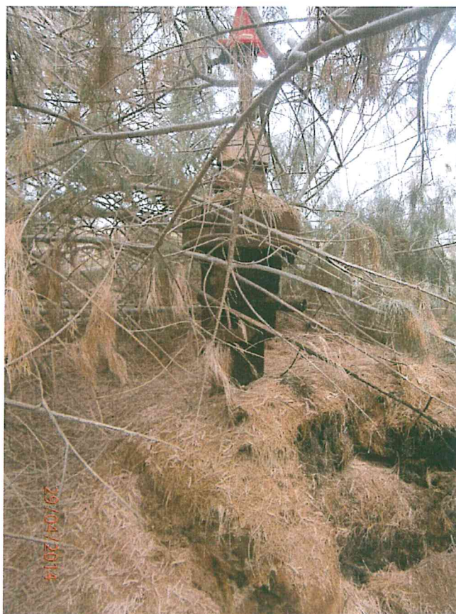
Fotografía N° 1. Vista del pozo con código PERUPETRO L2068, con casing de 9 5/8 plg aproximadamente de diámetro, corroído, que sobresale aproximadamente 2 m del nivel de superficie del suelo.
