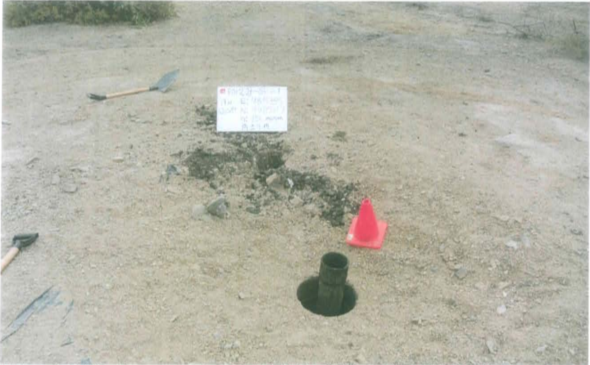
Fotografía N° 01.- Pozo con código PERUPETRO T2014 con Ficha OEFA F01725, se observa el casing y una tubería de reducción sin cabezal por lo que se encuentra descubierto al ambiente.
