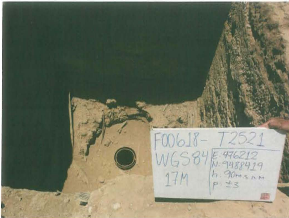
Fotografía N° 1. Pozo inactivo con código PERUPETRO T2521, se observa casing corroído a nivel del suelo dentro de cantina de 4 m de profundidad.
