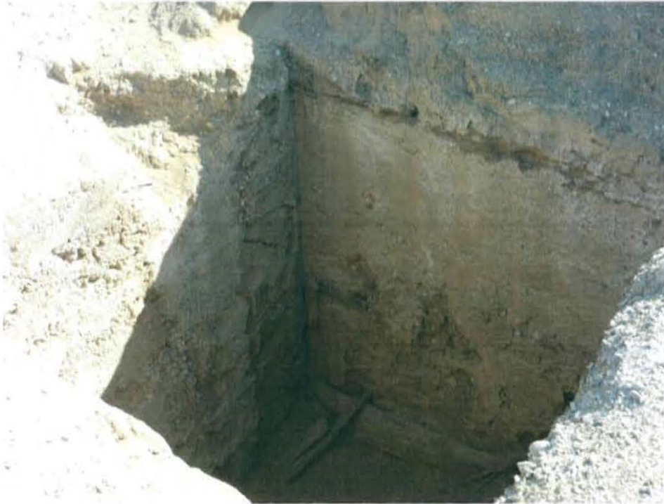
Fotografía N° 3. Cantina deteriorada de 4 m de profundidad desde el nivel del suelo.
