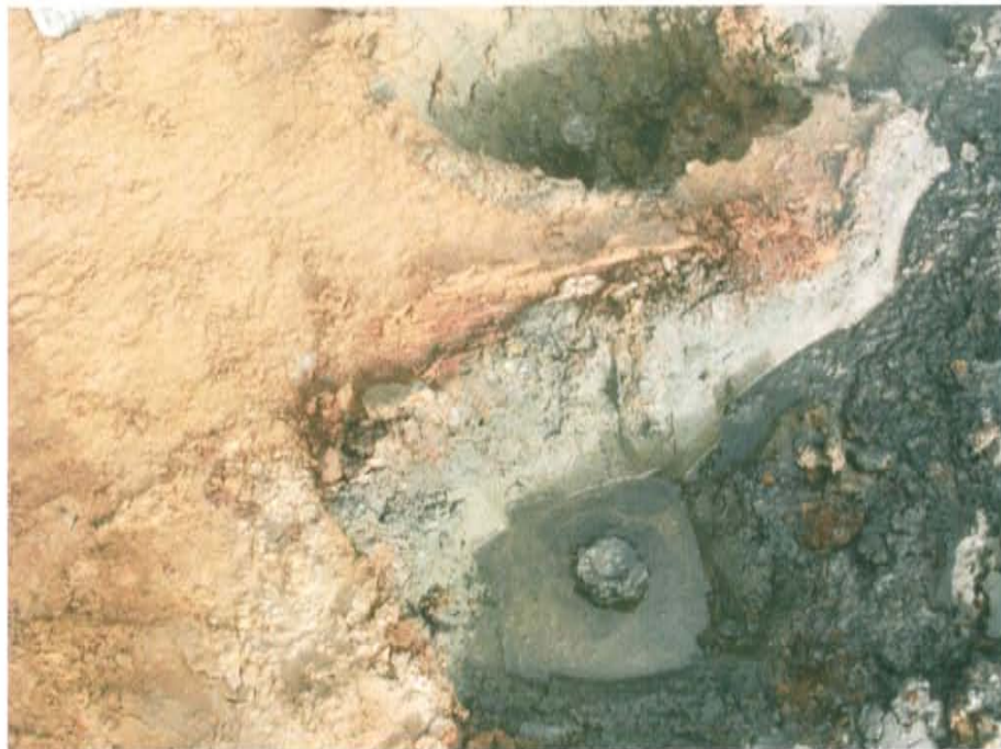
Fotografía N° 2. Después de una pequeña excavación se observan dos varillas metálicas abiertas por donde aflora el líquido y se percibe emisiones gaseosas.
