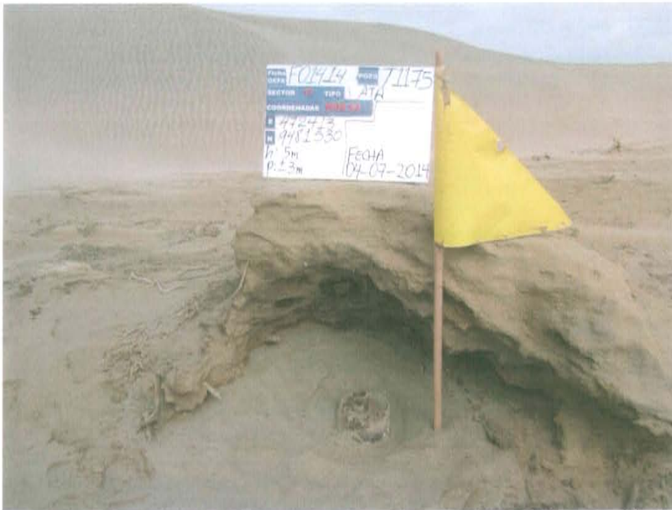
Fotografía N° 1. Se observa el Pozo T1175, con casing y tubing corroídos, cortados y expuestos al ambiente.
