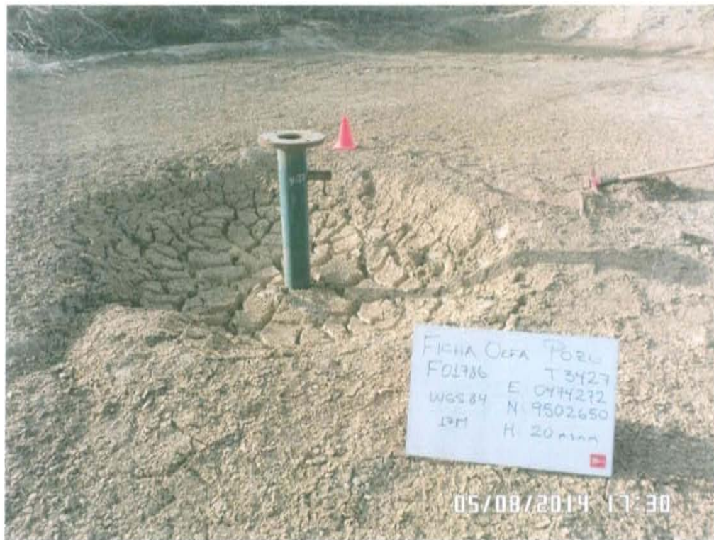
Fotografía N° 1. Identificación del pozo inactivo con código PERUPETRO T3427. Presenta casing con brida y sin válvulas abierto al medio ambiente.
