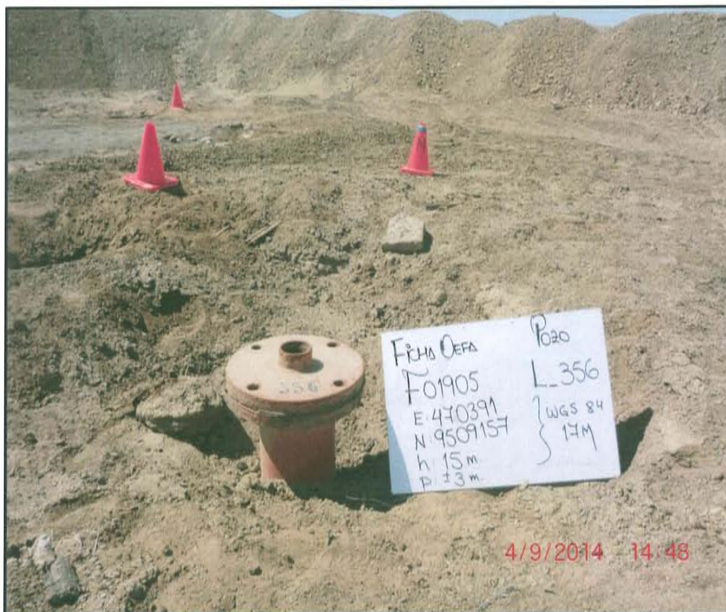
Fotografía N° 1. Cabezal del pozo compuesto por brida de 12 plg unida al casing de 8 plg que emerge 0,5 m desde la base del hoyo.
