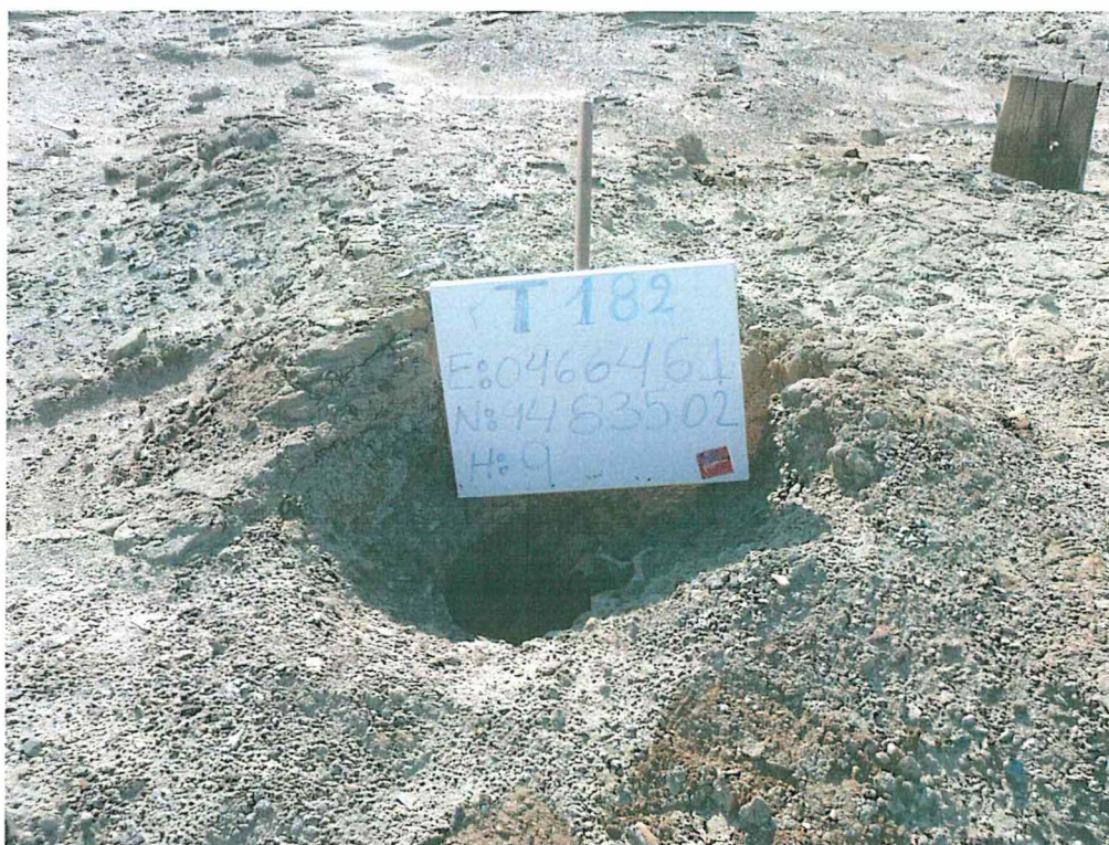
Fotografía N° 1. Pozo con código PERUPETRO T_182 inactivo mal abandonado, sin cabezal con casing de revestimiento a nivel de la superficie del suelo.
