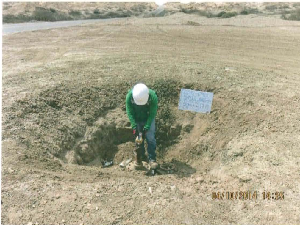
Fotografía N° 4. Medición en el punto F01541-EM01, ubicado en la boca del pozo.
