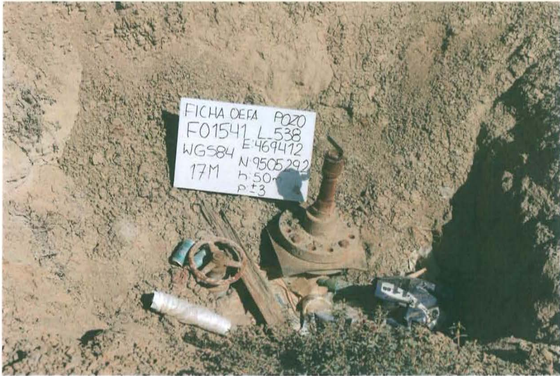
Fotografía N° 1. Identificación del pozo inactivo con código PERUPETRO L_538. Presenta casing y válvulas deterioradas en el interior de una excavación de sección circular.
