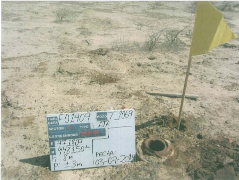
Fotografía N° 1. El Pozo T1069 presenta doble casing corroídos y cortados al ras del suelo, sin cabezal ni válvulas que aseguren su hermetismo.
