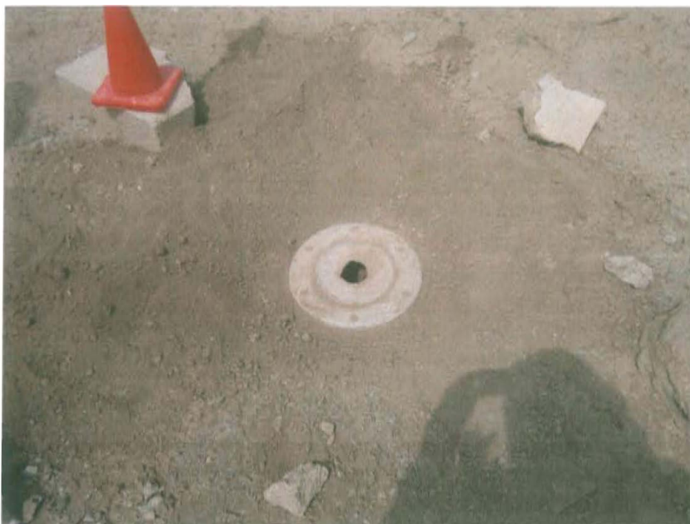
Fotografía N° 3. El casing a nivel superficial no presenta dispositivos de cierre por lo que se considera abierto.
