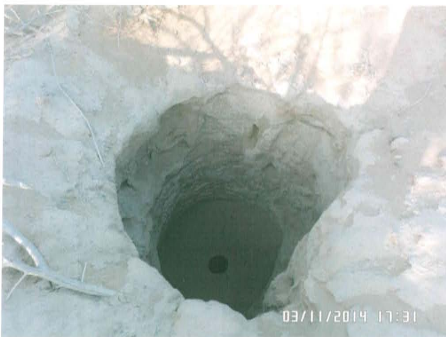
Fotografía N° 2. Se observa que la estructura del pozo que presenta casing cortado abierto carente de elementos de cierre que garanticen el cierre hermético del pozo.
