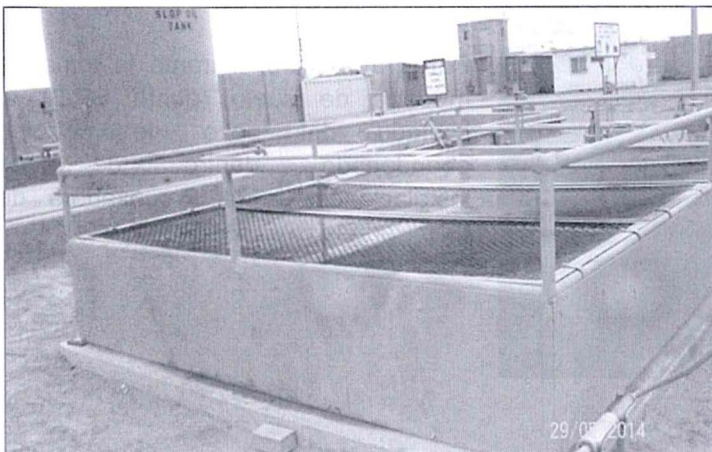
Fotografía N° 9. La poza API donde se trata los residuos de Hidrocarburos y otros del proceso de criogenización de la Procesadora de Gas Pariñas SAC; que no tiene facilidades para la toma de muestras que permita medir la calidad del sistema de tratamiento. SAC. 29 de mayo 2014.
