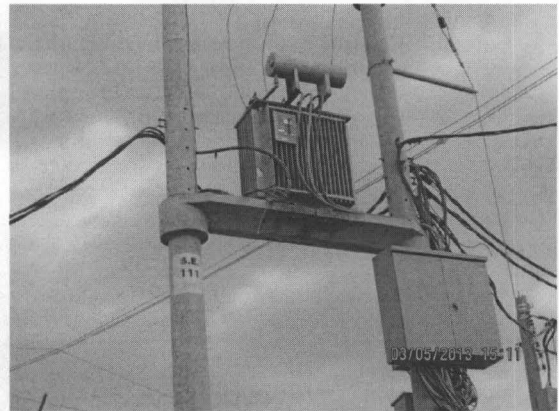
Foto 12: Equipo de SE aérea con fuga de aceite, rotulado como < 50 ppm. Ica (054)
