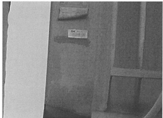
Foto 16: Rotulo rojo deteriorado por el tiempo del equipo aéreo (059)
