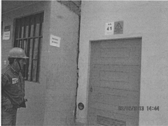
Foto 07: Equipo de subestación de superficie evaluado en la ciudad de Ica
