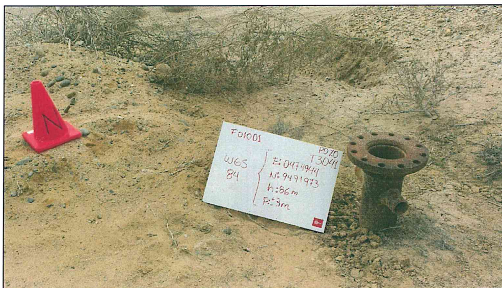
Fotografía N° 1. Vista del Pozo T3042, casing con cabezal incompleto y sin válvula que asegure su hermetismo.
